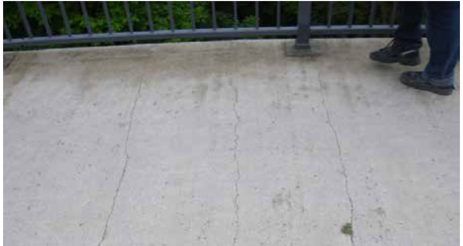
Bild 12: Deutliche Rissbildung in den Kappen
