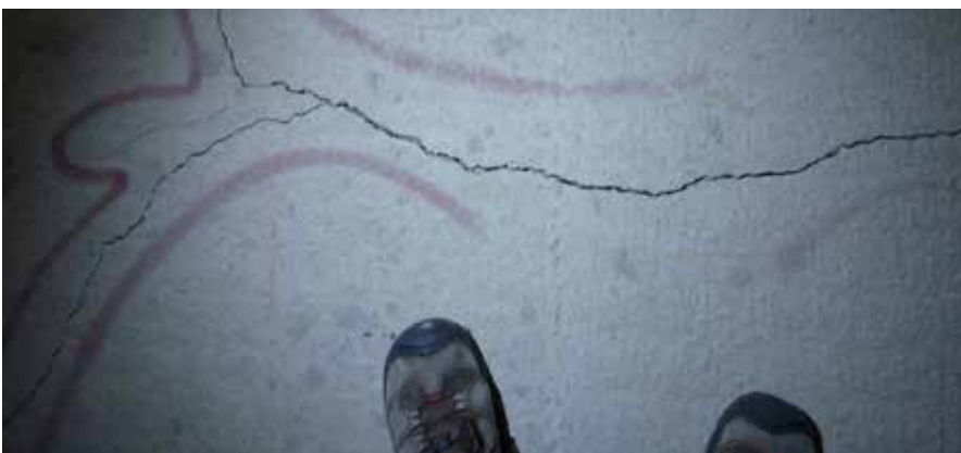
Bild 11: Starke Risse im Aufbeton über dem Altwiderlager
