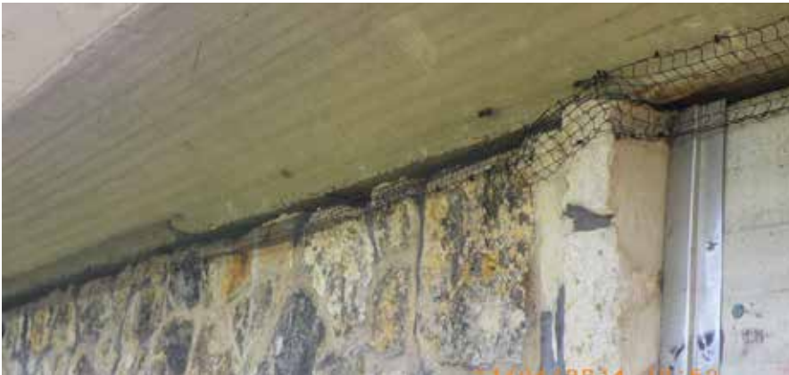
Bild 9: Vogeleinflugschutz, wenig dauerhaft und beschädigt
