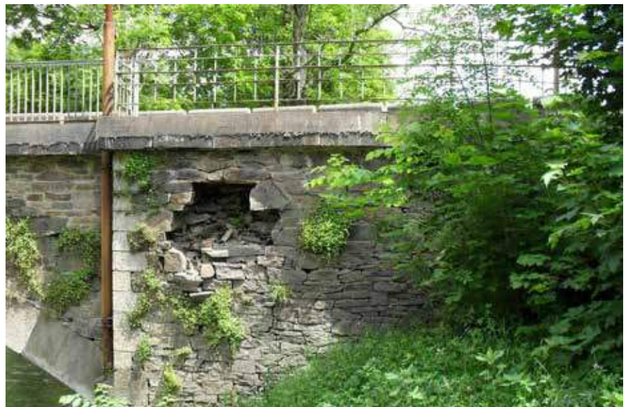
Bild 3: Schadbild Stirnwand Oberstrom
